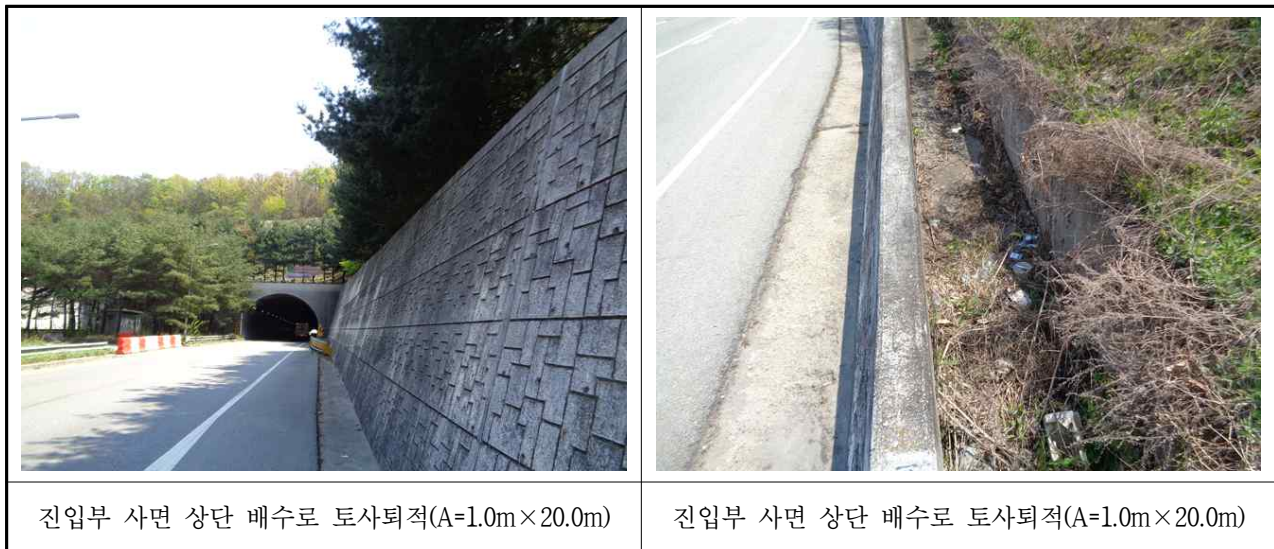
【사진 3.10】 사면 손상현황
