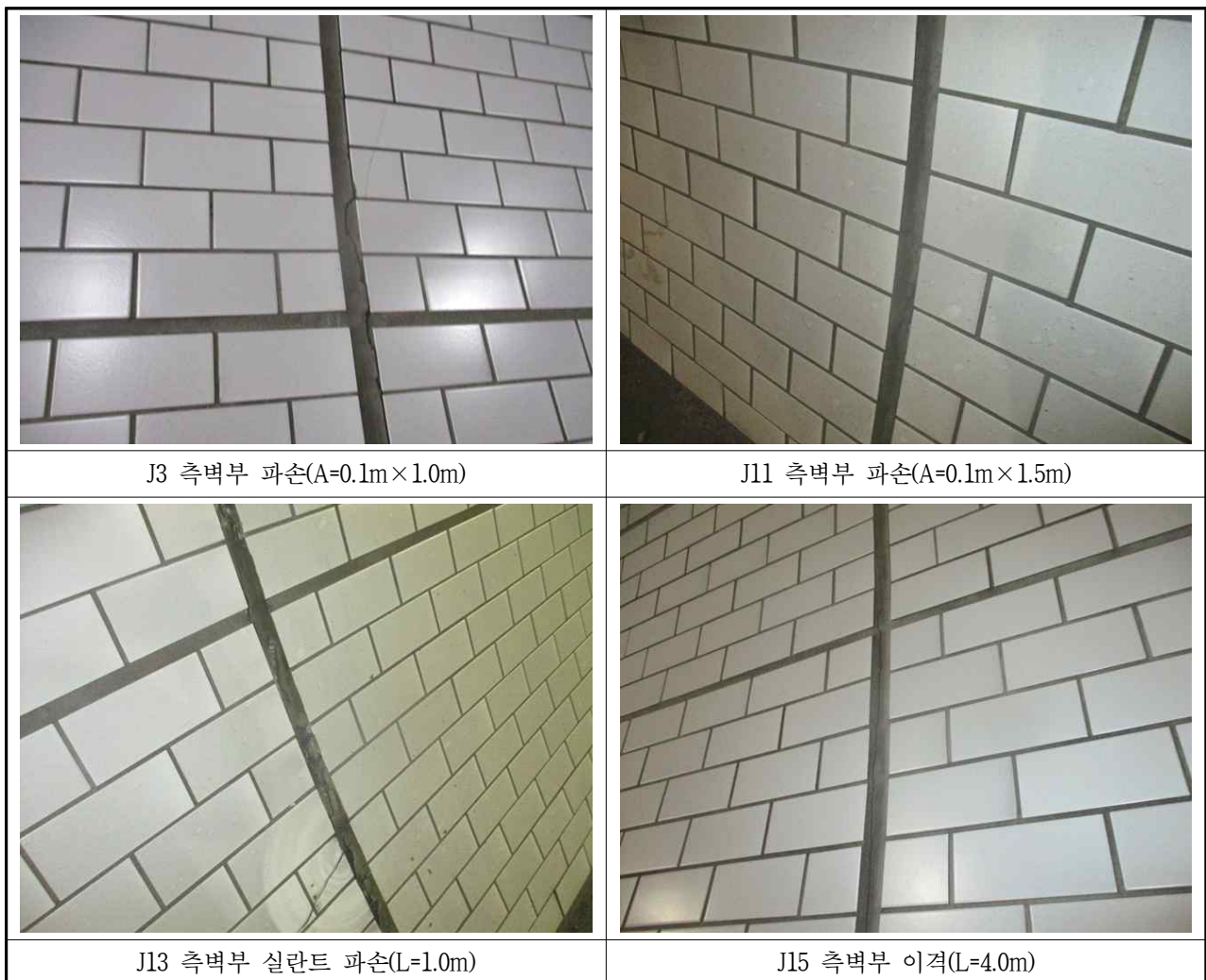
【사진 3.6】 측벽부 손상현황
